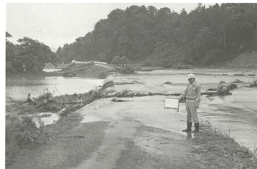
水が引き始めると流出木が残った。一斉被害調査(西根坂水)
