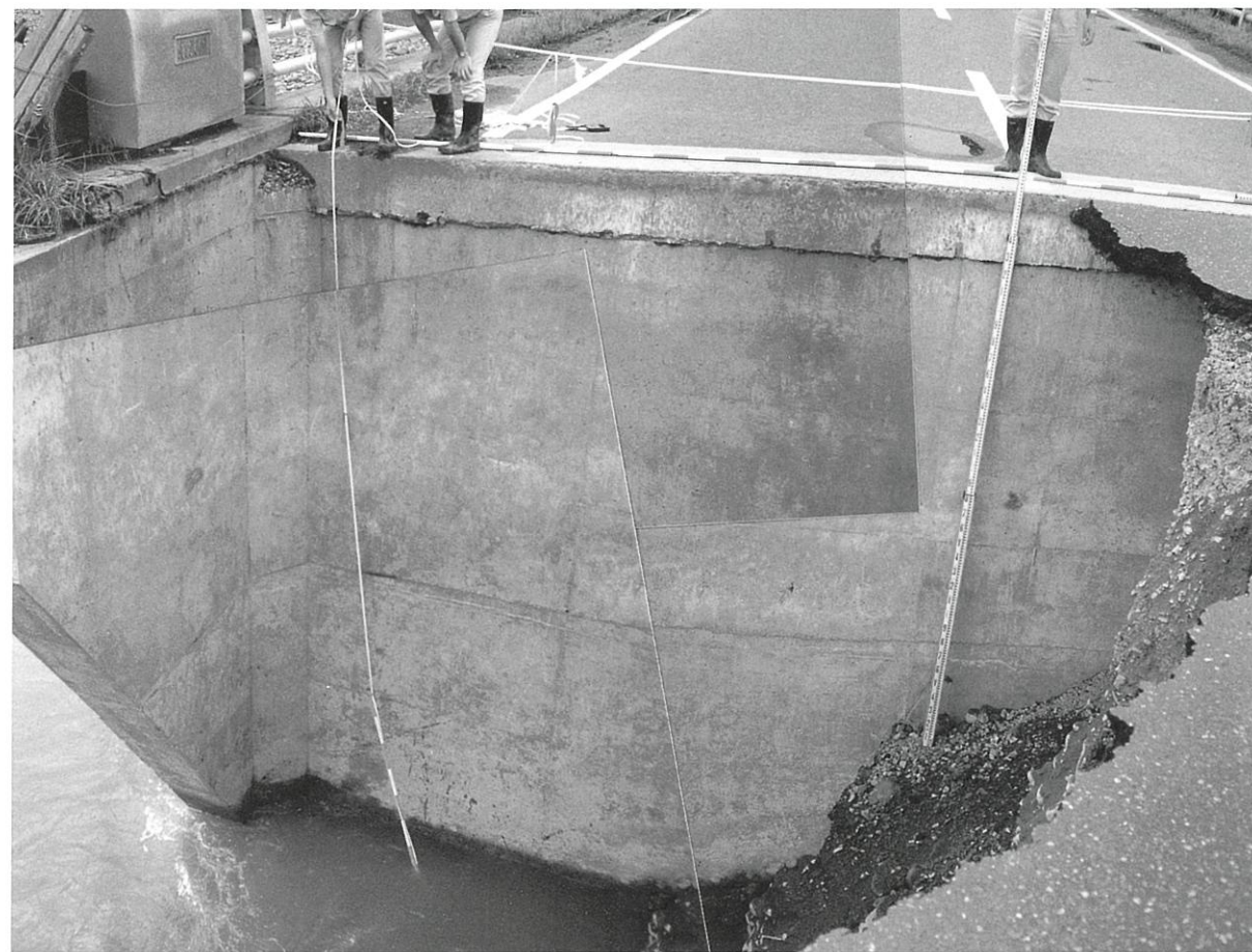
永沢橋の災害のツメ跡は大きかった。
