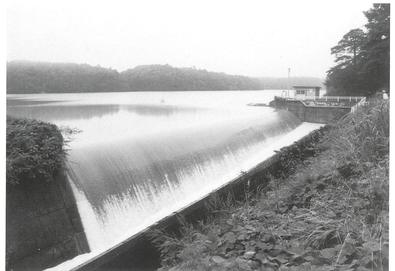
増水により余水吐からあふれる千貫石溜池 左岸擁壁裏が豪雨により流失した。
