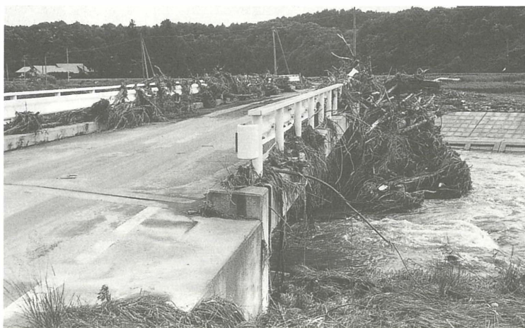
欄干が損傷を受けた稲沢橋
