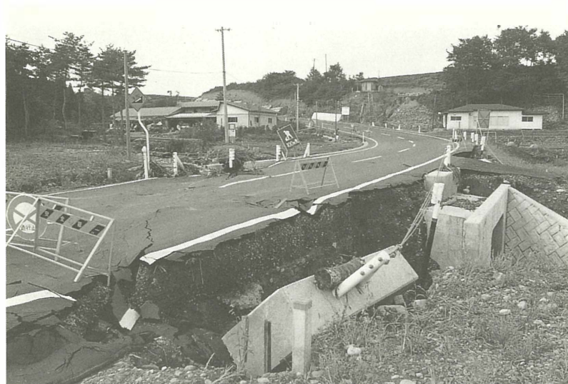
水が舗装の下を走り、舗装面が波うった。(永栄細野)
