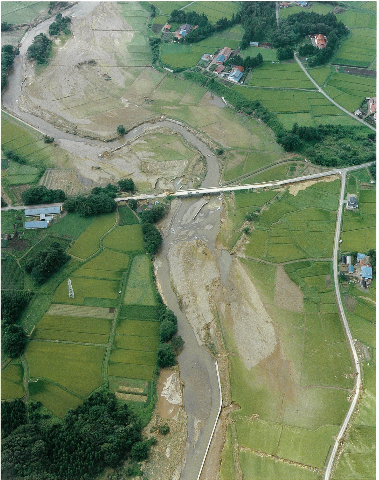
取場石橋附近の被災状況
