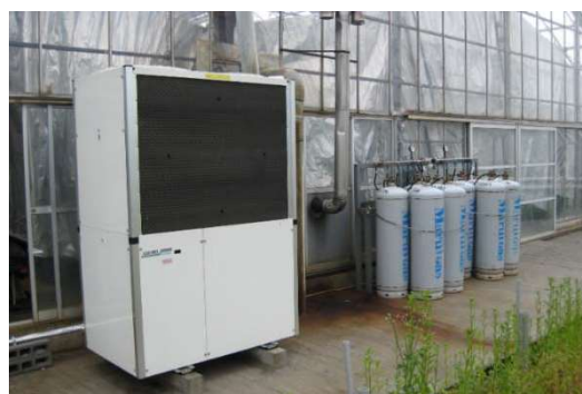
ガスヒートポンプ（室外機）
