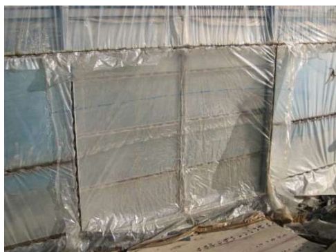
使用しない出入口を目張り
