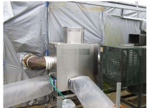
排熱回収装置
