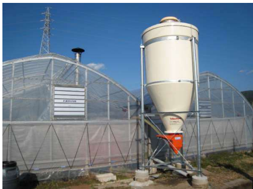
貯蔵タンクの設置スペース
