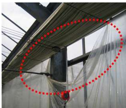
肩部の垂れ下がりによる隙間
