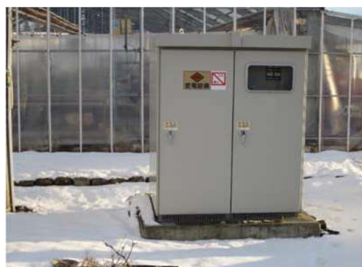
高圧受電設備（キュービクル）
