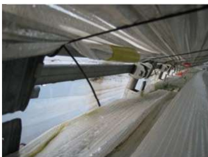
多層カーテン肩部の隙間
