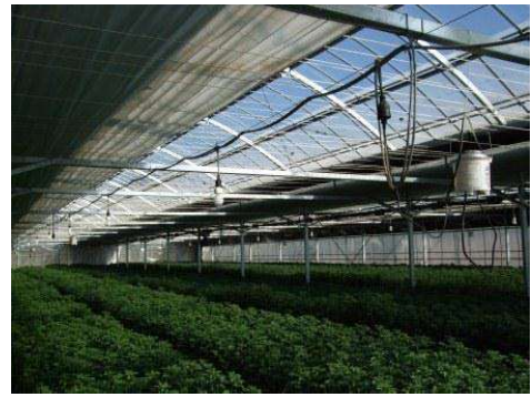
内張カーテンの自動開閉
