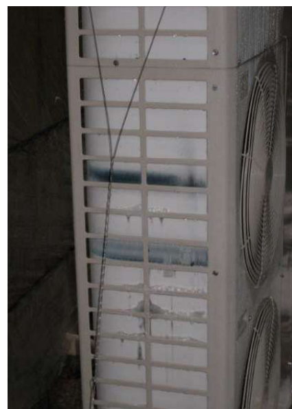
霜が付着した室外機
