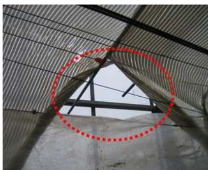
天井カーテンの隙間（妻面）
