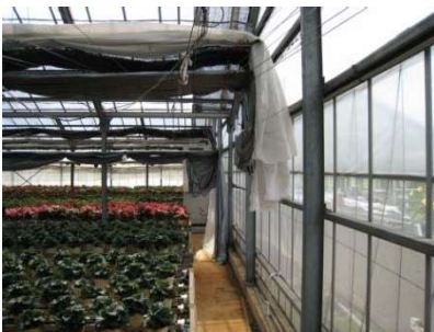
妻面のカーテンの隙間
