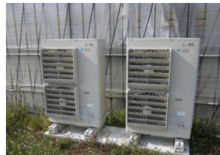
風向ガイドを取り付けた室外機
