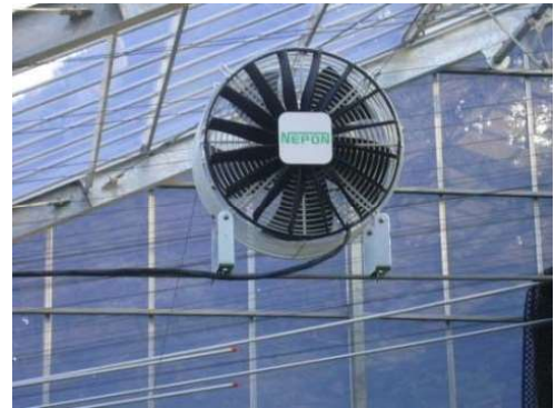
空気の流れをつくる循環扇
