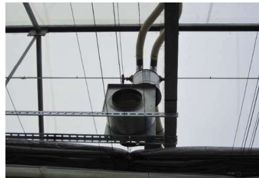
空気膜の加圧のための送風ファン
