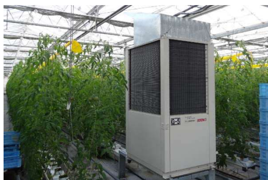
地下水熱源ヒートポンプ（室内機）
