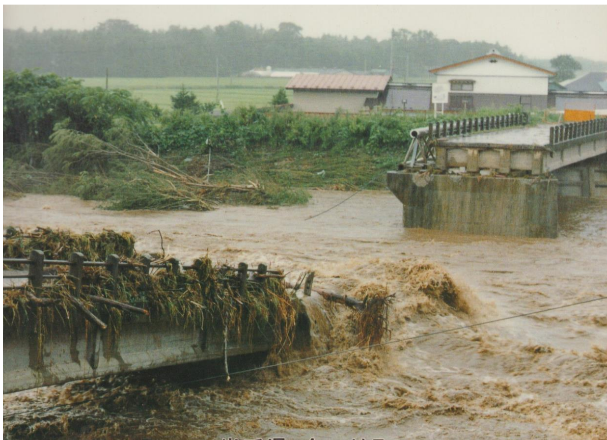
昭和63年8月水害 一級河川北上川水系黒沢川「川原田橋」流失の状況
