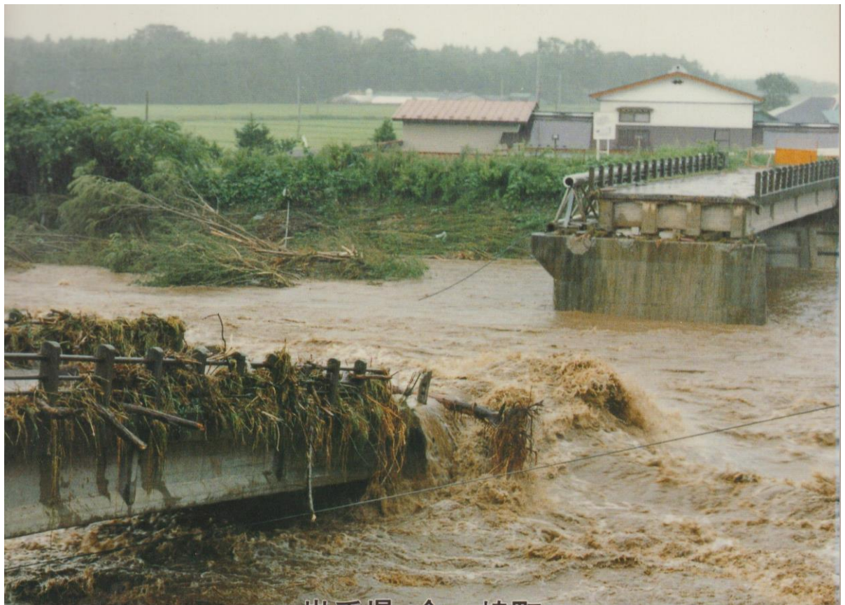
昭和63年8月水害 一級河川北上川水系黒沢川「川原田橋」流失の状況
